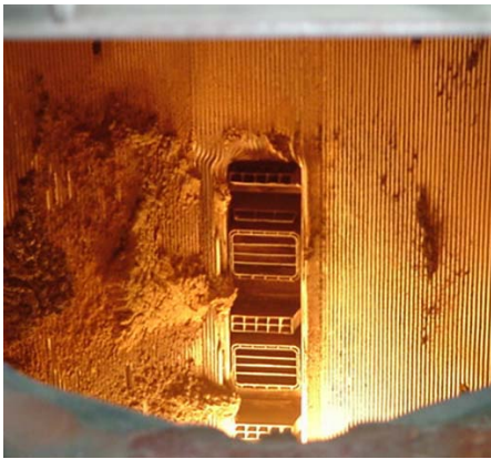
รูปที่ 1 ตะกรันที่เกาะอยู่บริเวณผนังหม้อไอน้ำในโรงไฟฟ้า
