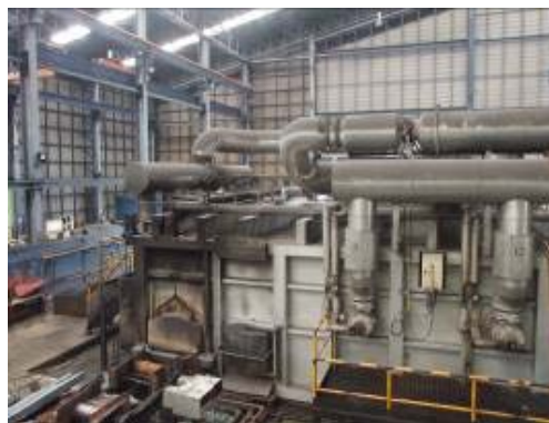
รูปที่ 1 ภาพ reheating furnace ที่ศึกษา
